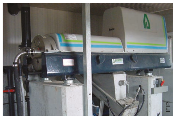
Décanteuse-centrifuge sur lisier de porc
